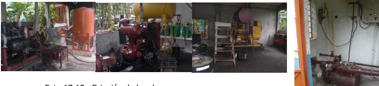
Foto 17-18 .Estación de bombeo
