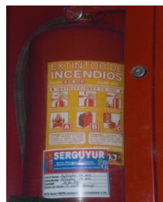
Foto 43. Extintor existente en Oficina
