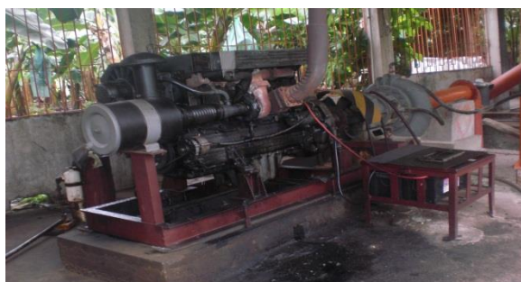
Foto 44. Motor de Riego con bandas de seguridad
