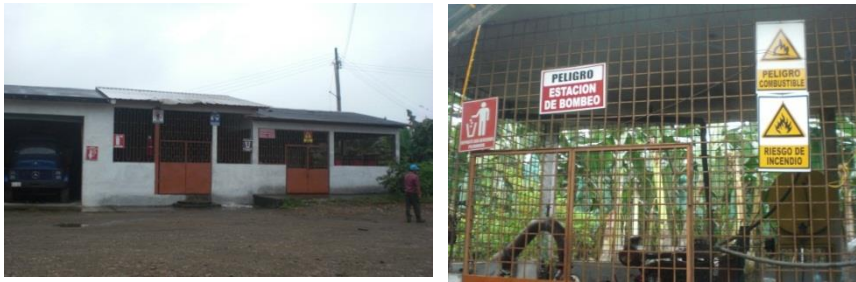
Foto 15-16 .Estación de bombeo
